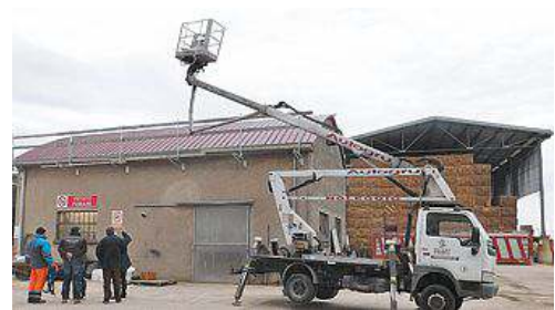
L'elevatore da cui sono caduti gli operai
